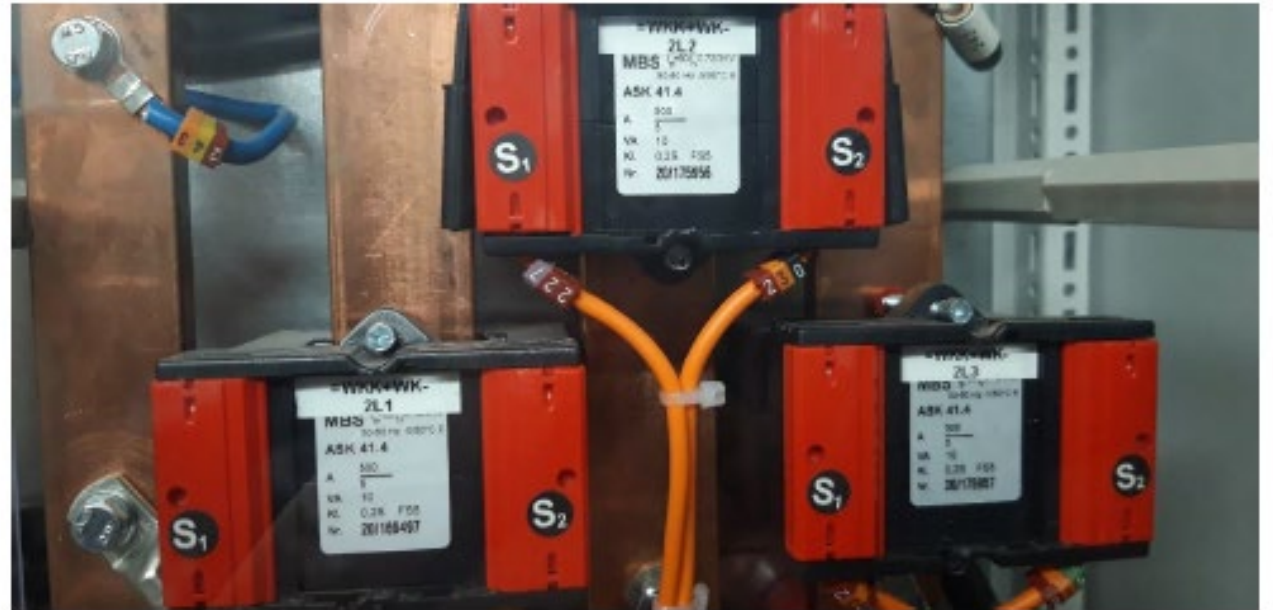
TI's (stroomtransformatoren) voor elektriciteitsmeting
