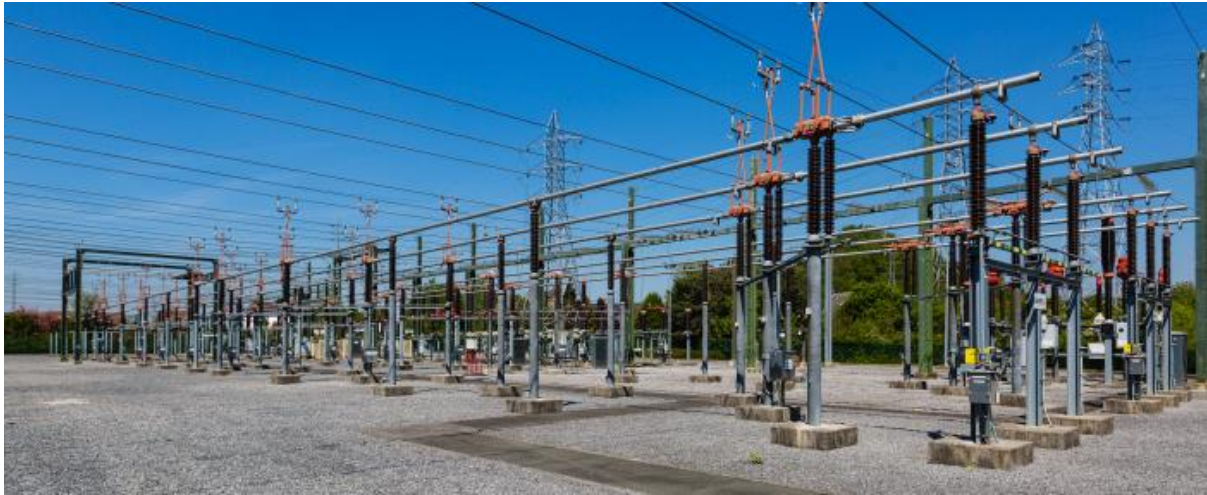
Figure 1.4 : sous-station 150 kV de type AIS
