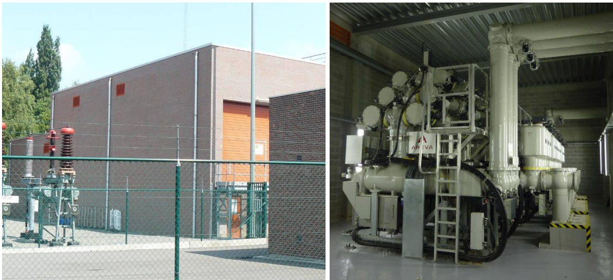
Figure 1.5 : sous-station 150 kV de type GIS
