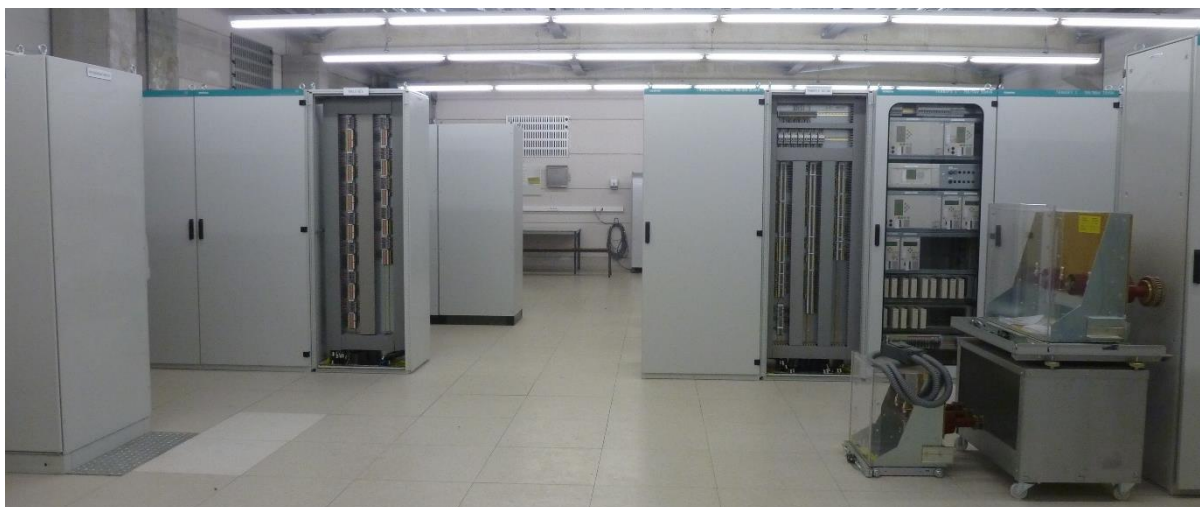
Figure 1.6 : équipements secondaires d'une sous-station
