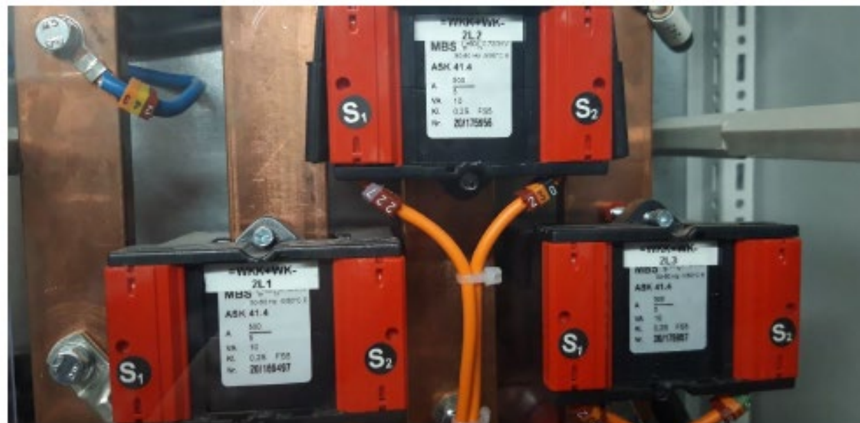
Photo 8 : TI (transformateurs de courant) pour le comptage électrique
