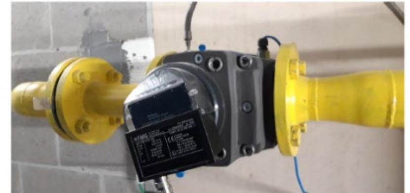
Photo 10 : Compteur débit gaz – scellé avec plombs (en bleu)
